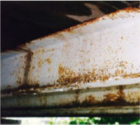
Kuva 2. Ruostumisaste Ri 4 (pistemäistä korroosiota)
