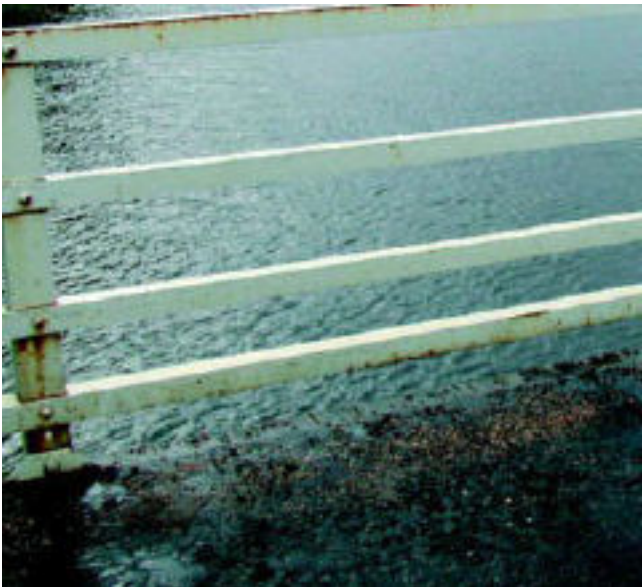
Kuva 4. Maalikerroksen alla on kauttaaltaan ruostetta, joten paikkausmaalauksella ei tule kysymykseen
