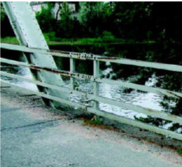
Kuva 3. Naarmut ja kolhut kaiteissa ovat tyypillisiä paikkausmaalauskohteita
