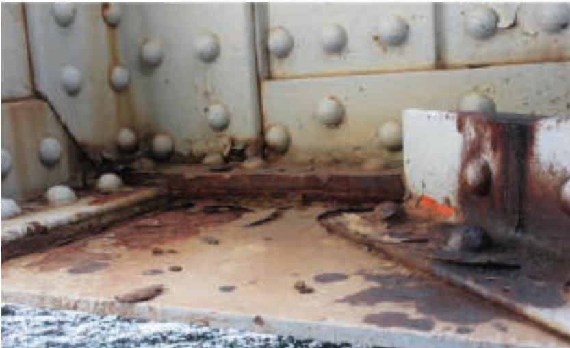
Kuva 1. Pinnoitteen vaurio epäpuhtauksia ja vettä keräävällä vaakapinnalla
