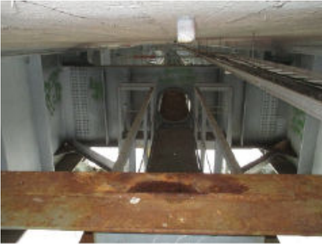
Kuva 2. Tippuputki on sijoitettu virheellisesti poikkiristikon kohdalle ja tippuputkesta valuva vesi on vaurioittanut pinnoitteen
