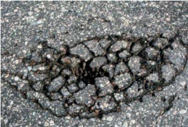
Kuva 8. Alkava purkauma sillan päällysteessä
