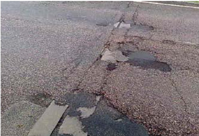
Kuva 9. Päällystevaurioita sillan liikuntasaumalaitteen vieressä
