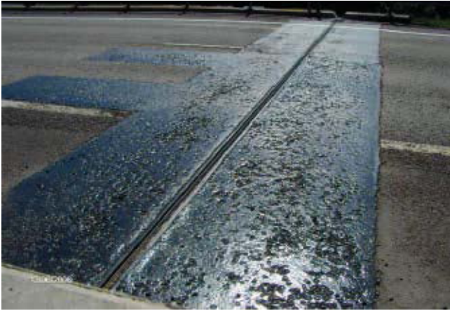
Kuva 21. Liikuntasaumalaitteen tukikaista kumibitumivaluasfaltista
