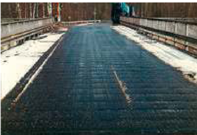
Kuva 5. Valuasfalttipäällysteen valumisvaurio läppäsillalla
