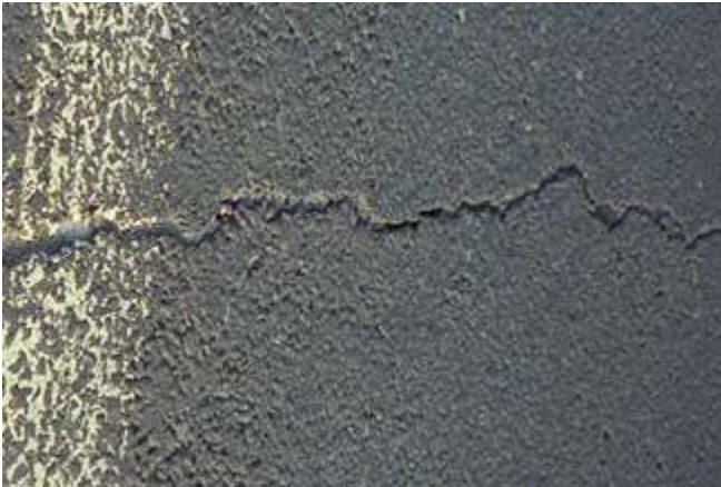
Kuva 6. Pakkasen aiheuttama kutistumishalkeama asfalttipäällysteessä
