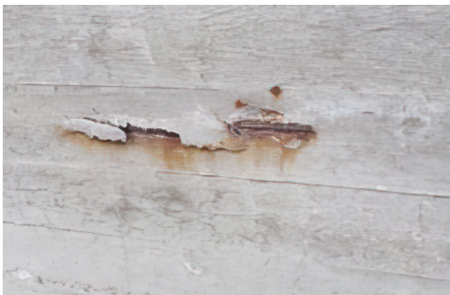
Kuva 3. Raudoitustangon betonipeitteen lohkeama
