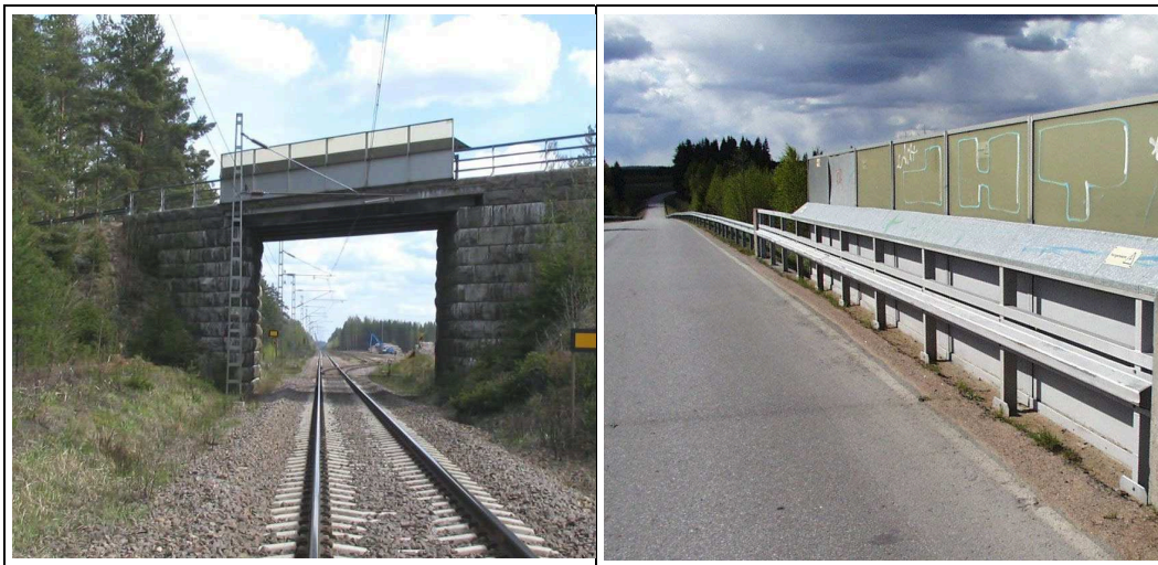
Kuva 16. Vasemmanpuoleinen kosketussuoja näyttää hyväkuntoiselta (merkintä A-sarakkeeseen), mutta oikeanpuoleisen sillan tapauksessa kosketussuojan toiseksi viimeinen lamelli näyttäisi olevan löysällä eli tarkastusmerkintä D-sarakkeeseen ja ilmoitus radan kunnossapitäjälle.
