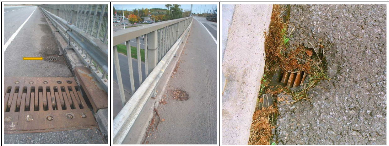
Kuva 14. Vasemmanpuoleisin syöksytorvi on kunnossa, mutta samassa sillassa oleva toinen syöksytorvi on tukossa (keskimmäinen kuva). Tällöin vuositarkastusmerkintä tulee sarakkeeseen B, ja lisätietoihin kannattaa kirjata, mitkä sillan lukuisista syöksytorvista on puhdistettava. Oikeanpuoleisimman sillan tapauksessa vuositarkastusmerkintä tulee B-sarakkeeseen.
