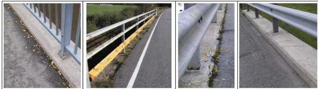
Kuva 8. Vasemmanpuoleisimmassa sillassa merkintä tulee B-sarakkeeseen, sillä sauma on puhdistettava. Kahdessa keskimmäisessä sillassa vuositarkastaja laittaa merkinnän C-sarakkeeseen, sillä saumat on kunnostettava. Oikeanpuoleisimmalla sillalla merkintä tulee D-sarakkeeseen, sillä sauma puuttuu kokonaan.
