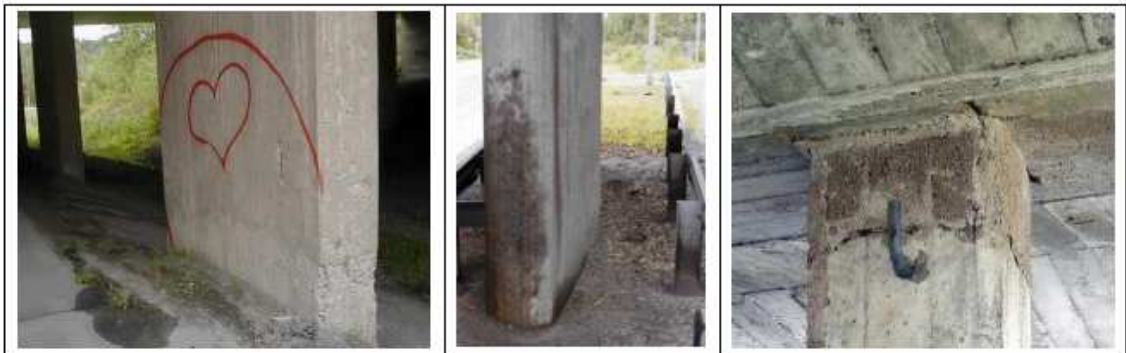
Kuva 2. Vuositarkastusmerkintä kuuluu B-sarakkeeseen kahden vasemmanpuoleisimman sillan välituen osalta. Vasemmanpuoleisessa tapauksessa irtonainen hiekka ja maa poistetaan välituen juurelta maanpinnan tasoon asti, keskimmaisessä pestään suolaroiskeet pois (vähintään 3 m korkeuteen saakka). Oikeanpuoleisessa kuvassa merkintä kuuluu sarakkeeseen D, sillä betoni on vaarallisesti lohkeillut välituen yläpäästä.
