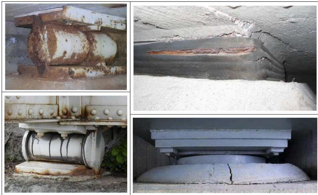
Kuva 13. Vasemmalla alhaalla rullalaakeri on hoidon suhteen kunnossa (A), mutta muiden laakereiden suhteen on ehdotettava korjausta (D), perusteluina voimakas ruostuminen, kumilamellien ulospuristuminen ja murtuminen sekä laakerikorokkeen halkeilu.
