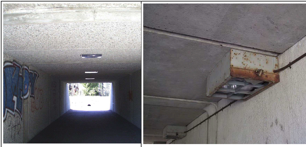
Kuva 17. Vasemmanpuoleisen alikulkukäytävän valaistuslaitteet ovat pääosin kunnossa (A), mutta oikeanpuoleisen alikulkukäytävän valaistuslaitteiden kunto on syytä saattaa tilaajan tietoon (D), sillä lamput ovat rikki ja valaisimet pahasti ruosteessa.
