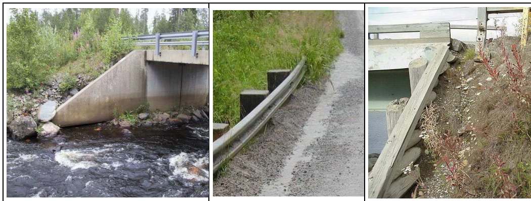
Kuva 23. Vasemmanpuoleisimman sillan tieluiska vaatii vesakon raivauksen (B) lisäksi korjausta (D). Keskimmäisessä sillassa tieluiskan reunapalteet on poistettava (C). Oikeanpuoleisen sillan tieluiska on ehdotettava korjattavaksi (D-sarake).
