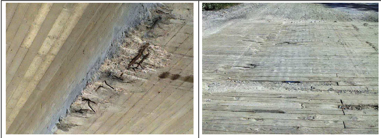
Kuva 4. Vuositarkastusmerkintä kuuluu D-sarakkeeseen vasemmanpuoleisen sillan osalta, sillä betonikannen alapinnassa on vakava törmäysvaurio. Oikeanpuoleisen sillan kansilaatan tapauksessa tulee vuositarkastuslomakkeeseen kaksi merkintää, B ja D: puukannella oleva hiekka on poistettava (B), mutta sen lisäksi kansi on niin pahasti kulunut, että asiasta on syytä raportoida tilaajalle(D).
