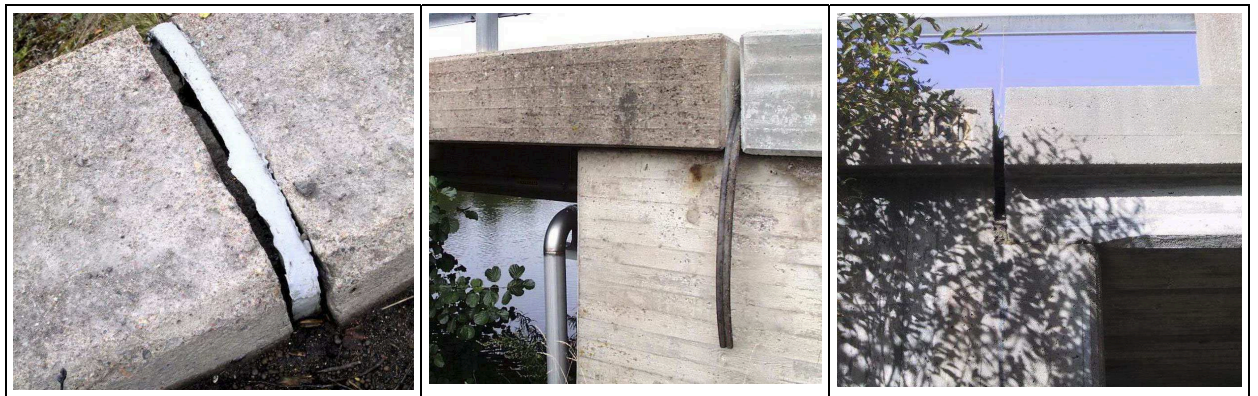
Kuva 7. Vasemmanpuoleisen ja keskimmäisen sillan tapauksessa vuositarkastaja laittaa merkinnän C-sarakkeeseen ja urakoitsija kunnostaa saumat 30.9. mennessä. Oikeanpuoleisimman sillan tapauksessa vuositarkastuslomakkeeseen tulee kaksi merkintää, B ja D, sillä jo rakennusvaiheessa avoimeksi jätetty reunapalkin liikuntasauama (D) on täynnä maata, hiekkaa ja muuta irtoainesta, joka pitää poistaa ja sauma puhdistaa (B).
