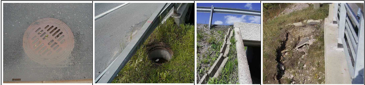
Kuva 20. Vasemmanpuoleisin hulevesikaivo vaatii puhdistuksen (B-sarake), kahdessa keskimmaisessä sillassa kuivatuslaitteiden kunto edellyttää urakoitsijalta kunnostustoimenpiteitä (C-sarake), mutta oikeanpuoleisimmassa kuvassa joudutaan jo korjaustoimiin (D).
