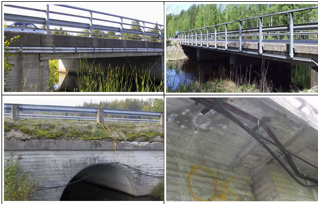
Kuva 18. Ylärivin vasemman puoleisessa sillassa kaapelin suoja-putket ovat kunnossa (merkintä A-sarakkeeseen) mutta oikean puoleisessa sillassa suojakotelo puuttuu maatuon osalta (merkintä D-sarakkeeseen). Alarivin silloissa kaapelien suojaus puuttuu sekä kiinnitys on puutteellinen, mikä aiheuttaa tarkastusmerkinnän D-sarakkeeseen.
