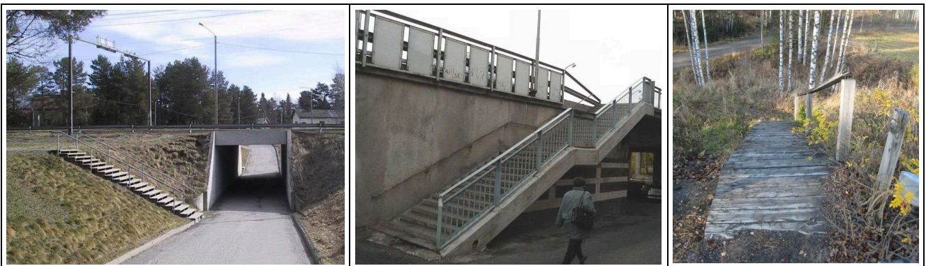
Kuva 24. Vasemmanpuoleisin ja keskimäinen silta ovat portaiden osalta kunnossa, joten vuositarkastusmerkintä tulee A-sarakkeeseen. Oikeanpuoleisimman sillan portaat vaativat kunnostustoimenpiteitä kaiteen osalta, joten vuositarkastaja kirjaa havainnon C-sarakkeeseen.
