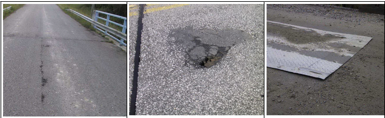
Kuva 5. Vuositarkastusmerkintä on laitettava C-sarakkeeseen kaikkien kolmen sillan osalta, sillä päällysteessä olevien halkeamien, reikien, purkauksien ja muiden liikennettä vaarantavien vaurioiden korjaukset kuuluvat hoitourakoitsijalle.
