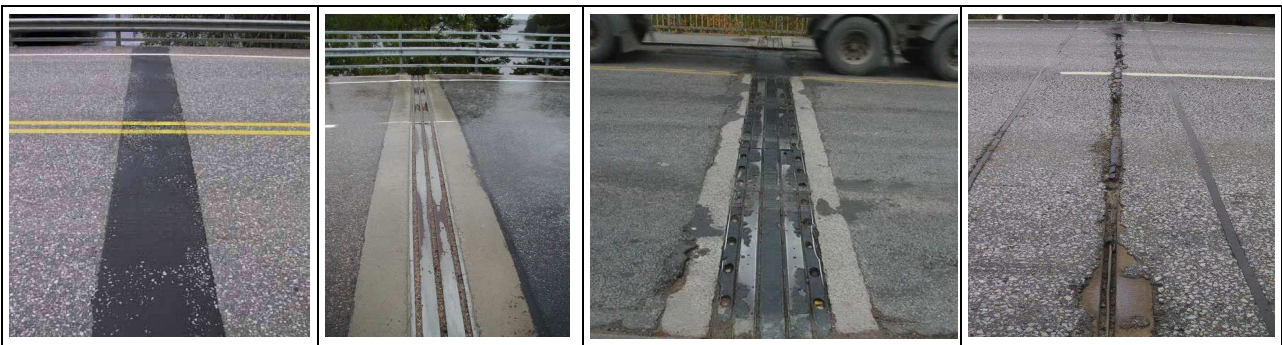
Kuva 12. Vasemmanpuoleisimmassa sillassa on massaliikuntasauma hyvässä kunnossa, joten vuositarkastusmerkintä tulee A-sarakkeeseen. Toiseksi vasemmanpuoleisimman sillan liikuntasaumalaite kaipaa puhdistusta, vuositarkastusmerkintä B-sarakkeeseen. Kaksi oikeanpuoleisinta liikuntasaumalaitetta on jo merkittävä korjausohjelmoitavaksi (D).
