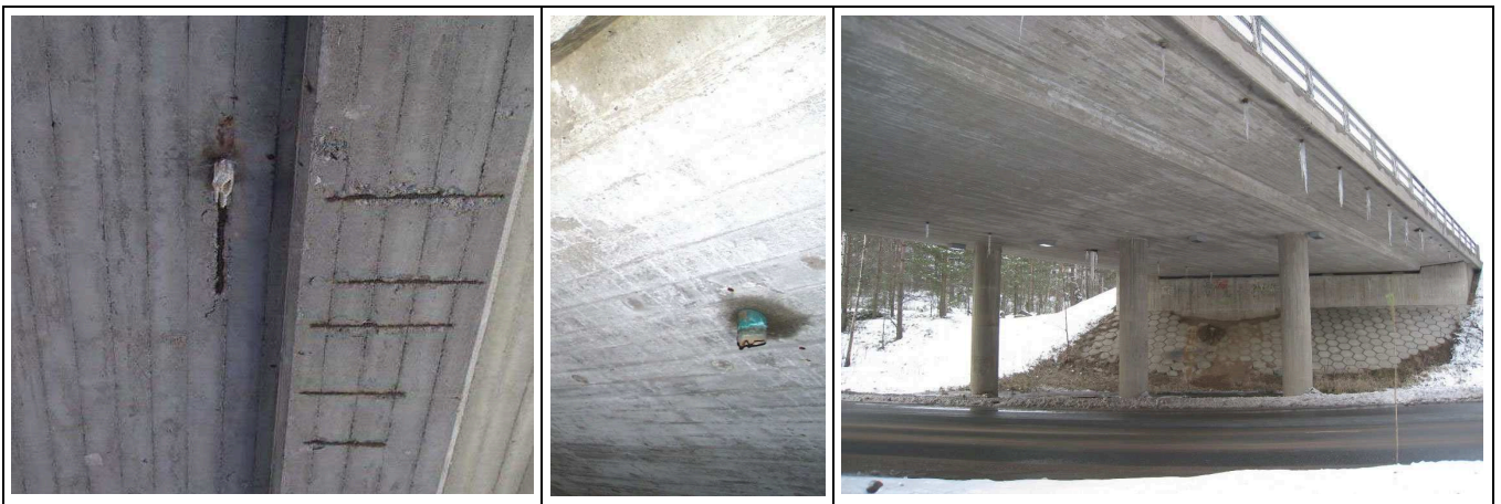
Kuva 15. Kaikkien siltojen tippuputkien osalta vuositarkastusmerkintä laitetaan D-sarakkeeseen, sillä tippuputket ovat tukossa, niiden ympärillä on selkeää vesivuotoa tai niistä valuu vesi alittavalle tielle. Oikeanpuoleisimman sillan ilmiö (tippuputkista valuvan veden aiheuttamat jääpuikot) ei toteudu vuositarkastuksen tekemisen aikoihin, mutta talvihoidon laatuvaatimusten mukaan liikennettä vaarantavat jääpuikot on poistettava. Nykyään tippuputkia ei enää ajoratojen kohdalle rakenneta, mutta vanhemmissa silloissa tilanne on valitettavan yleinen.
