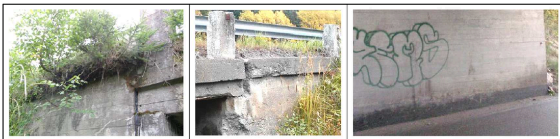
Kuva 1. Vuositarkastusmerkintä B-sarakkeeseen kaikkien siltojen maatukien osalta, sillä maatuissa tai niiden päällä on kasvillisuutta ja maa-ainesta (vasen ja keskimmäinen silta) ja maatuet tulee niiltä osin puhdistaa, tai kyseessä on suolasumun rasittama risteys sillan maatuki (oikea silta), joka on selkeästi likainen ja puhdistamatta alaosastaan. Keskimmäisen sillan maatuen rapautuminen edellyttää merkinnän myös D-sarakkeeseen.
