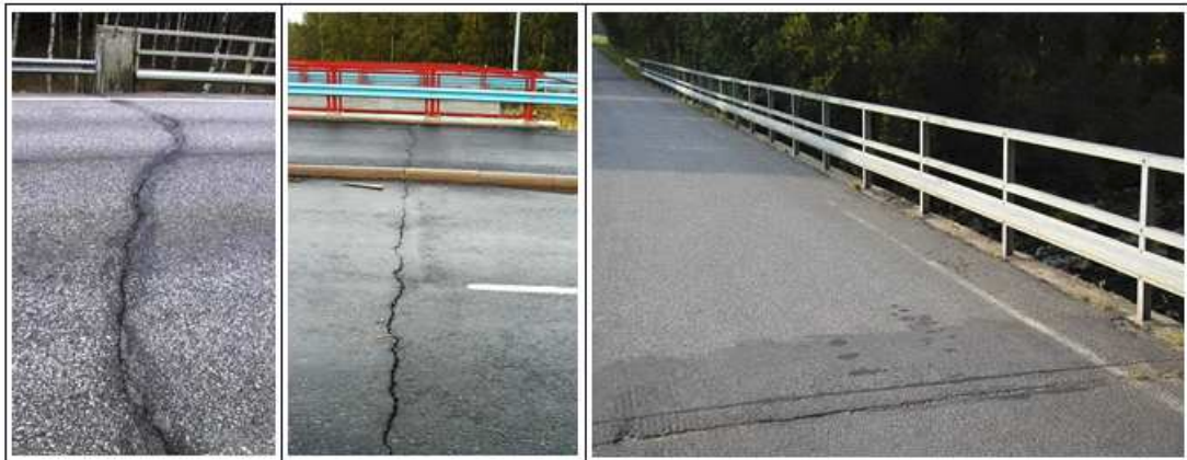
Kuva 9. Vasemmanpuoleisimman ja keskimmäisen sillan tapauksessa vuositarkastusmerkintä tulee C-sarakkeeseen, sillä sillan päällysteeseen sillan ja penkereen rajamaille on ilmestynyt poikkisuuntainen halkeama, jonka korjaaminen kuuluu urakoitsijalle. Oikeanpuoleisimmassa sillassa on saumaa jouduttu korjailemaan useasti, ja voi olla asianmukaista ehdottaa tilaajalle päätysauman korjausta. Tällöin laitetaan vuositarkastusmerkintä sarakkeeseen C lisäksi sarakkeeseen D.
