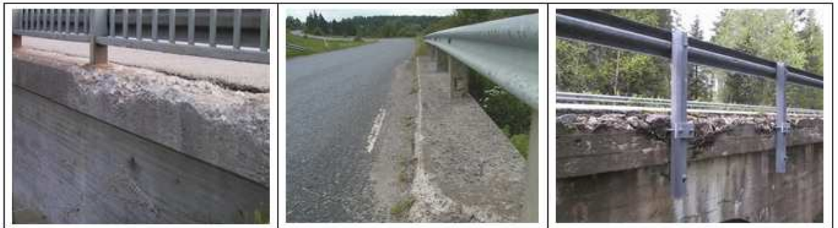
Kuva 6. Vasemmanpuoleisimman sillan reunapalkki on kunnossa hoidon hoitourakoitsijan näkökulmasta (vaikka rapautumaa onkin) eli vuositarkastusmerkintä laitetaan A-sarakkeeseen. Keskimmäisen sillan reunapalkki kaipaa puhdistusta (merkintä B-sarakkeeseen). Oikeanpuoleisimman sillan kaiteen kiinnitys on heikentynyt reunapalkin huonon kunnan vuoksi, joten vuositarkastusmerkintä laitetaan D-sarakkeeseen.
