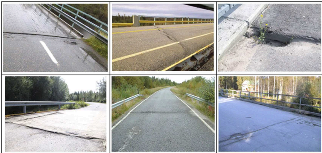
Kuva 10. Kaikkien siltojen tapauksessa sillan ja penkereen välisen kynnyksen poisto kuuluu hoitourakoitsijalle, eli vuositarkastusmerkintä tulee C-sarakkeeseen. Alarivin oikeanpuoleisimman sillan tapauksessa myös D-sarake voisi olla mahdollinen C-sarakkeen lisäksi, sillä sillan päätykohtaa on jouduttu paikkailemaan jo useampaan kertaan.
