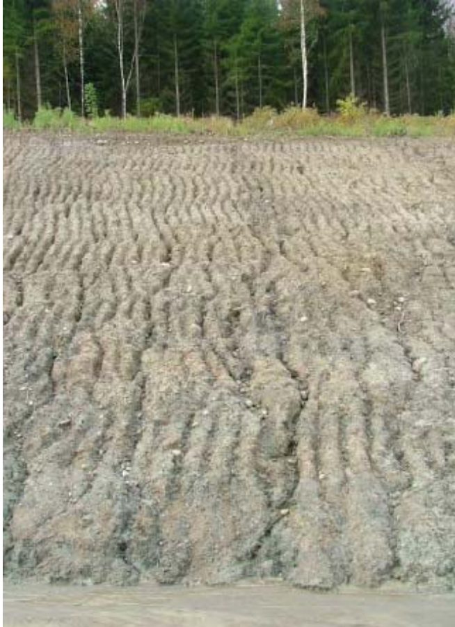
Kuva 8.2 Esimerkki tapahtuneesta pintavesierosiosta / (Håndbok 274, Statens vegvesen 2008-4)
