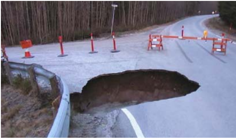
Kuva 8.4 Tien sortuma, pengermateriaalia on huuhtoutunut arteesisen vedenpaineen vaikutuksesta/ Håndbok 016/ Statens vegvesen, /
