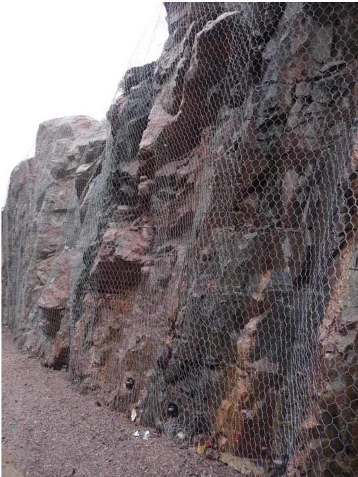
Kuva 10.5 Kallioleikkauksen lujitus systemaattisella pultituksella ja suojaus teräsverkolla kohteessa, jossa kevyenliikenteen väylä on 0,5-1 m kallioleikkauksen juuresta (kuva Panu Tolla)
