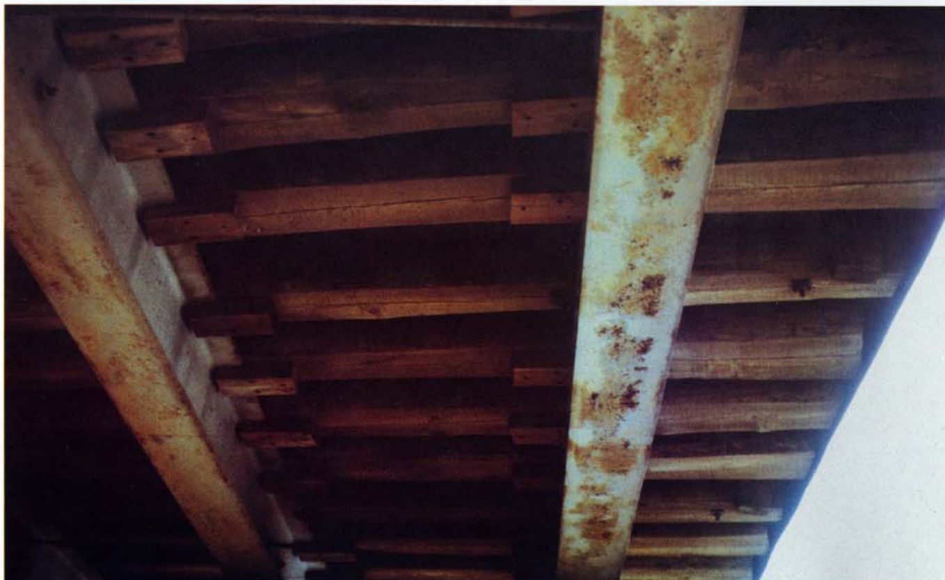
Kuva 3. Vasemman puoleisen pääkannattajan laipan alapinnan ruostumisaste on Ri 3; 65 % ja Ri 4; 35 %. Oikean puoleisen pääkannattajan laipan alapinnan ruostumisaste on Ri 2; 5 %, Ri 3; 35 %, Ri 4; 55 % ja Ri 5; 5 %.
