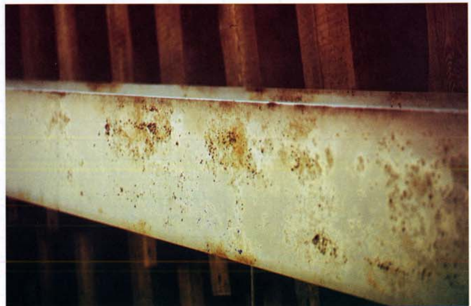
Kuva 6. Laipan alapinnan ruostumisaste on Ri 2; 5 %, Ri 3; 70 % ja Ri 4; 25 %.
