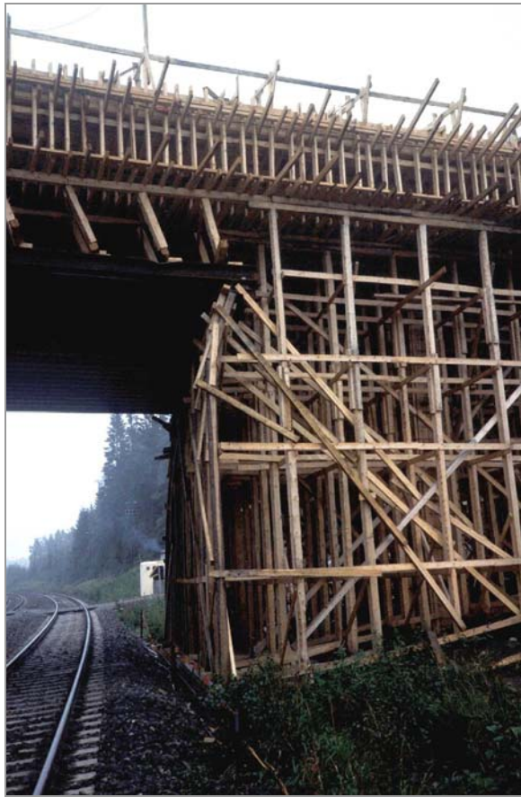
Kuva 3: Riittämätön vinotuenta ja puutteelliset tolppien jatkokset
