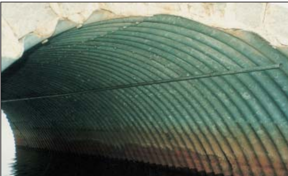
Kuva 15. Vetojohde putkisillan seinämässä.
