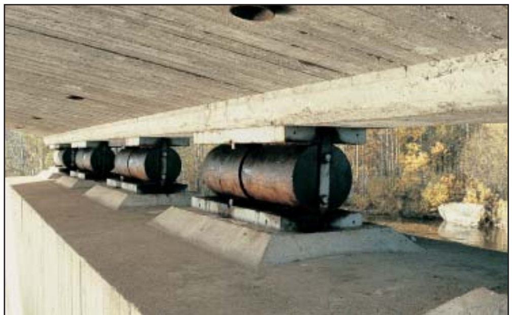
Kuva 6. Helposti hoidettavat välituen laakerit.
