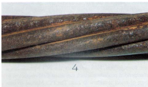
2g. Korroosioaste 3A. Ennen puhdistusta.
