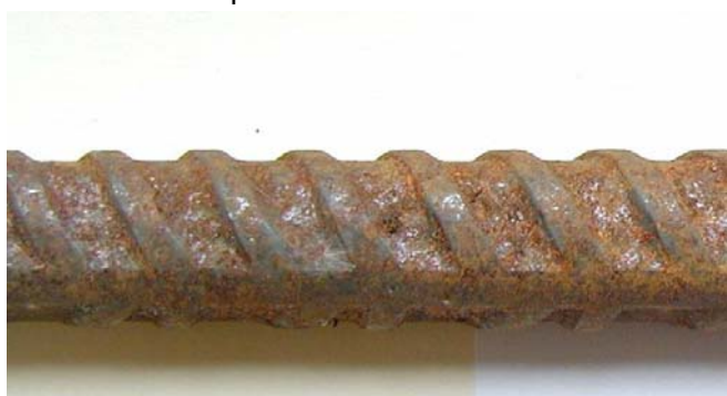
1c. Korroosioaste 1. Ennen puhdistusta.
