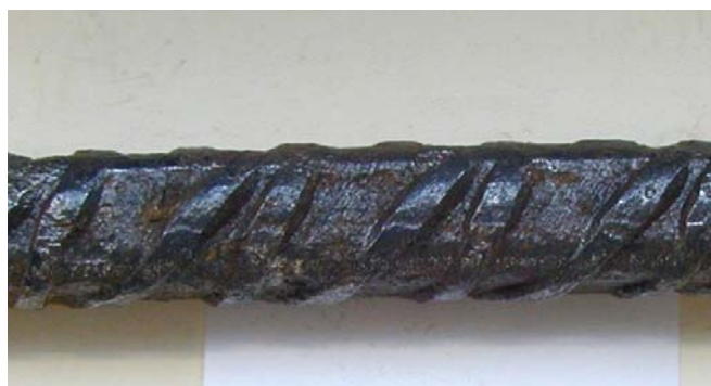
1h. Korroosioaste 3. Teräsharjauksen jälkeen.
