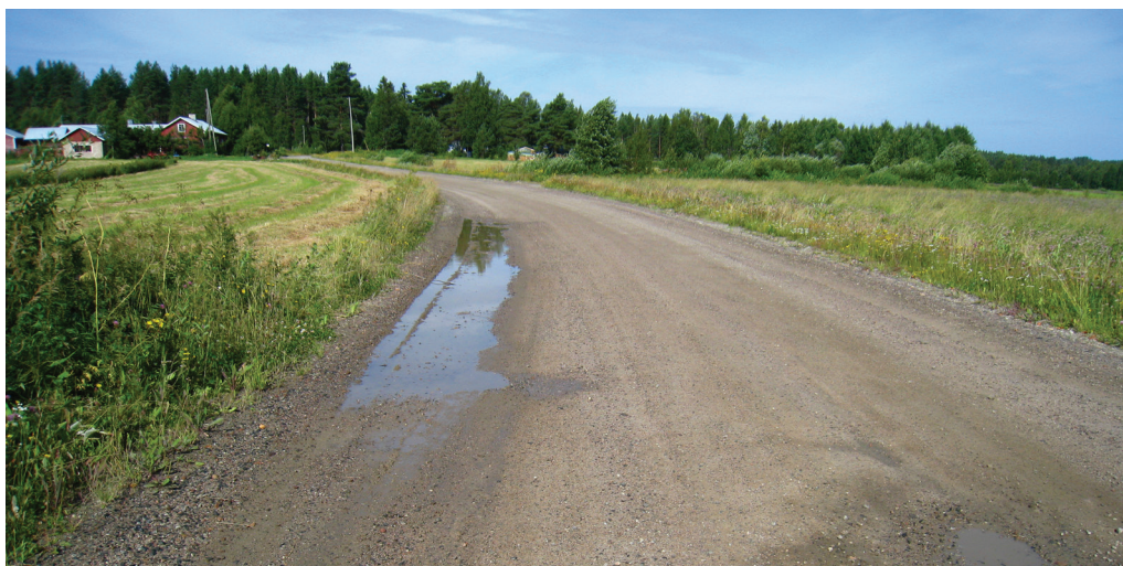
Kuva 4. Reunapalle estää veden poistumisen ja vaurioittaa pintaa.
