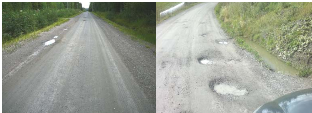
Kuva 14. Korkea piennar eli reunapalle estää pinnan kuivatuksen ja aiheuttaa vaurioita. Vesi seisoo sivuojassa tukkeutuneen liittymärummun takia, jolloin rakenteeseen imeytynyt vesi reikiinnyttää tienpinnan.
