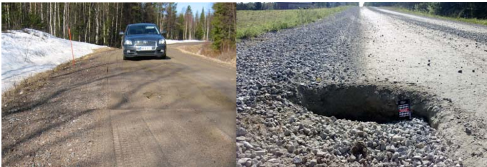
Kuva 6. Rumpuheitto ja rumpun rikkoutumisen aiheuttama reikä.
