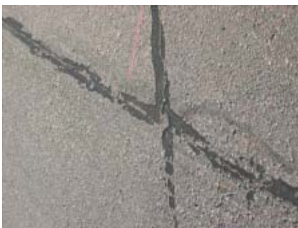
Kuva 17. Massalla paikkaamisen pitäisi olla vain väliaikainen korjaustapa. Ensisijaista on uudelleen päällystäminen.
